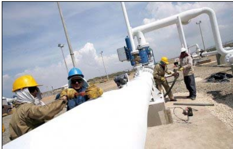
Figura 3. Primer plano de un gasoducto
