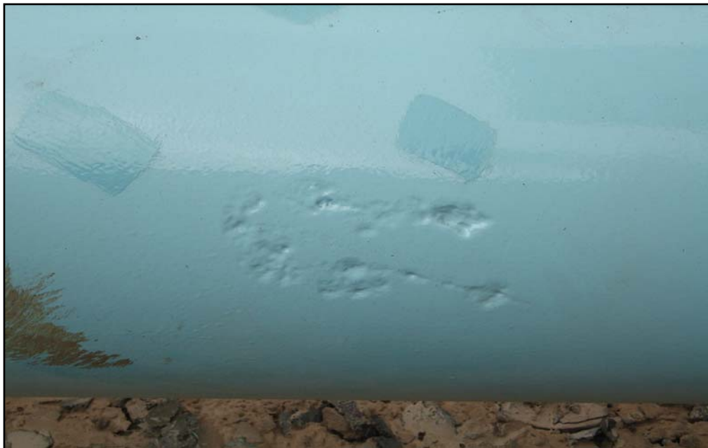
Figura.14 PK 141+505 Detalle sector pintado con alta presencia de corrosión. Tomado de un informe del cambio de revestimiento en el gasoducto
