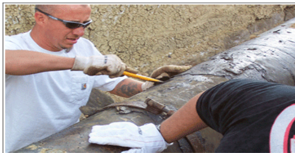
Figura 9. Deterioro en línea de transporte causado por corrosión externa.
