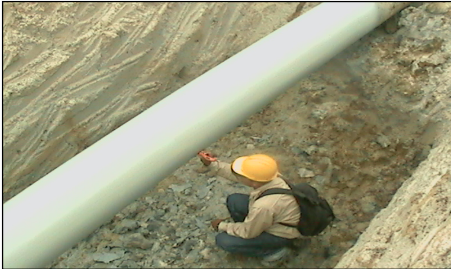
Figura.12. PK 168+380. Tubería revestida 100% sólidos.
