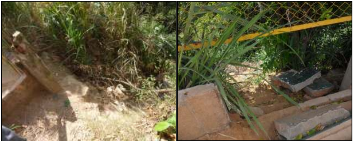
Ilustración 11. Evidencias Erosivas y Falla en las estructuras existentes
