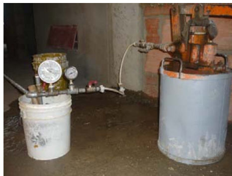
Figura 19. Flauta, manómetro, y bomba de presión.
