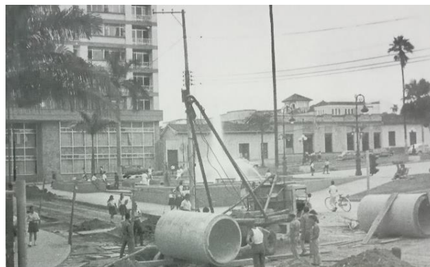
Red de Alcantarillado de Bucaramanga
