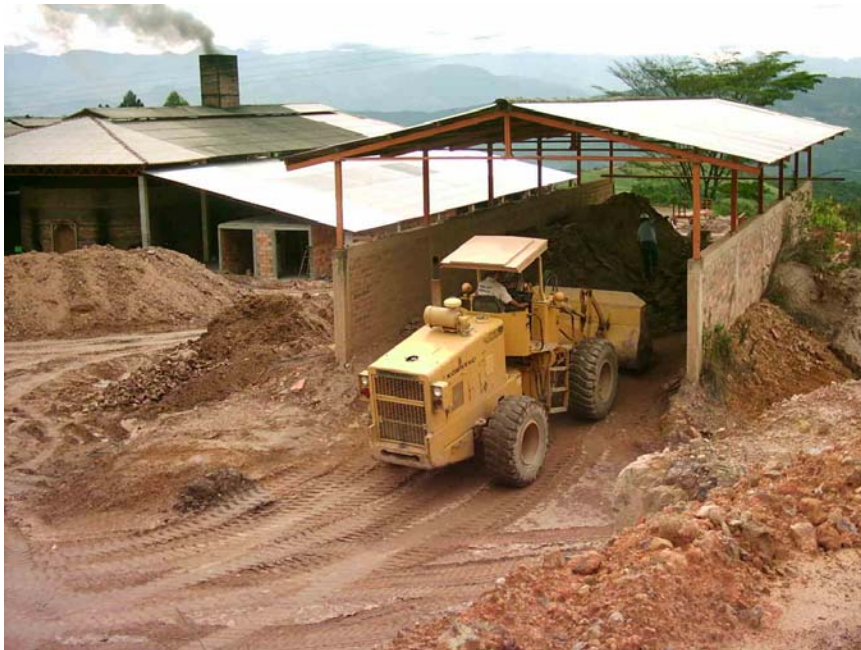
Figura 14. Entrada al proceso de molienda seca.
