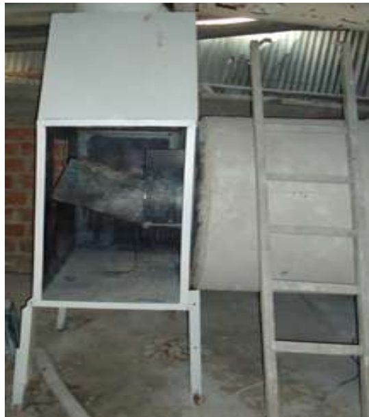
Figura 12. Cabina de alimentación
