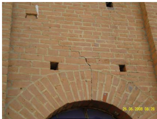
Figura 5.24 Detalle de una de las grietas del tambor en la cúpula
