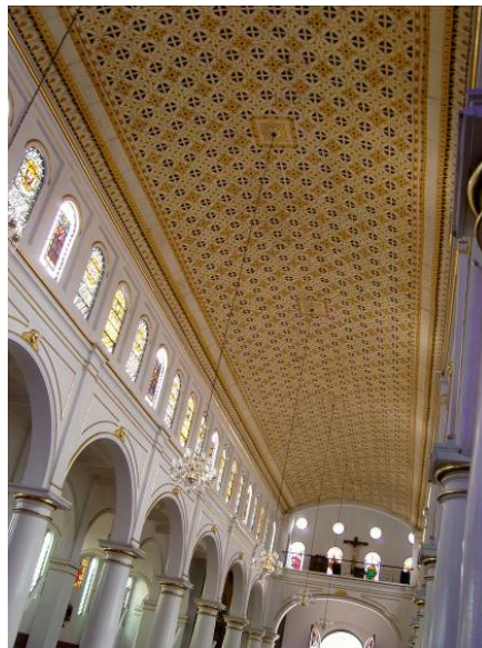
Figura 5.15 Vista de la obra pictórica de la bóveda de lámina acanalada de la nave central. Fuente: Las autoras
