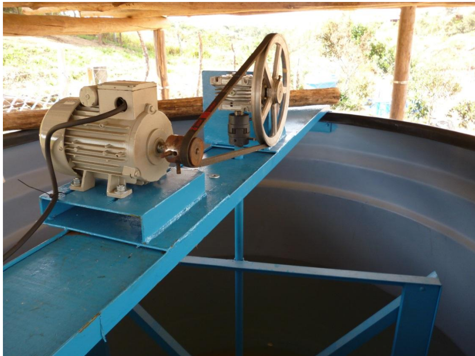
Figura 6. Unidad de floculación.
