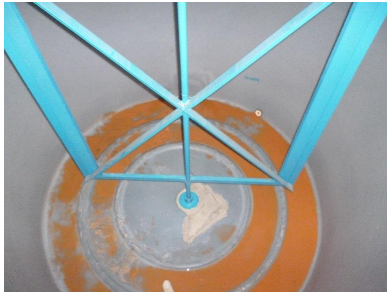
Figura 5. Estructura de ángulo de la unidad de floculación.
