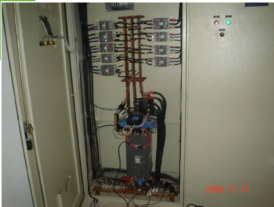
Figura D.4 Tablero general de distribución edificio CENTIC
