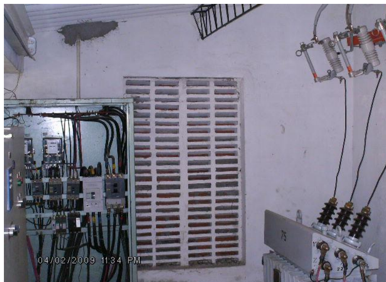
Figura 2.17 Sistema de respaldo eléctrico de Administración
