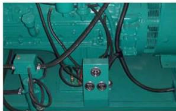
Figura 1.6 Control de señalización
