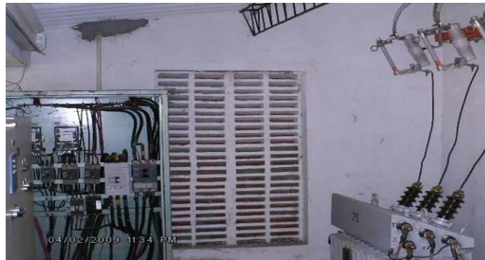
Figura 2.24 Instalación eléctrica edificio de administración
