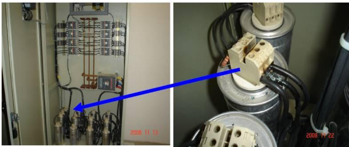
Figura 2.4 Banco de condensadores edificio CENTIC
