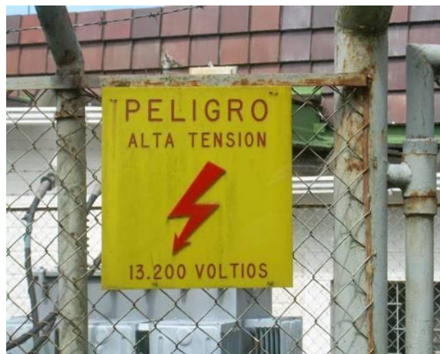
Figura 2.21 Señales de Seguridad sede Guatiguará
