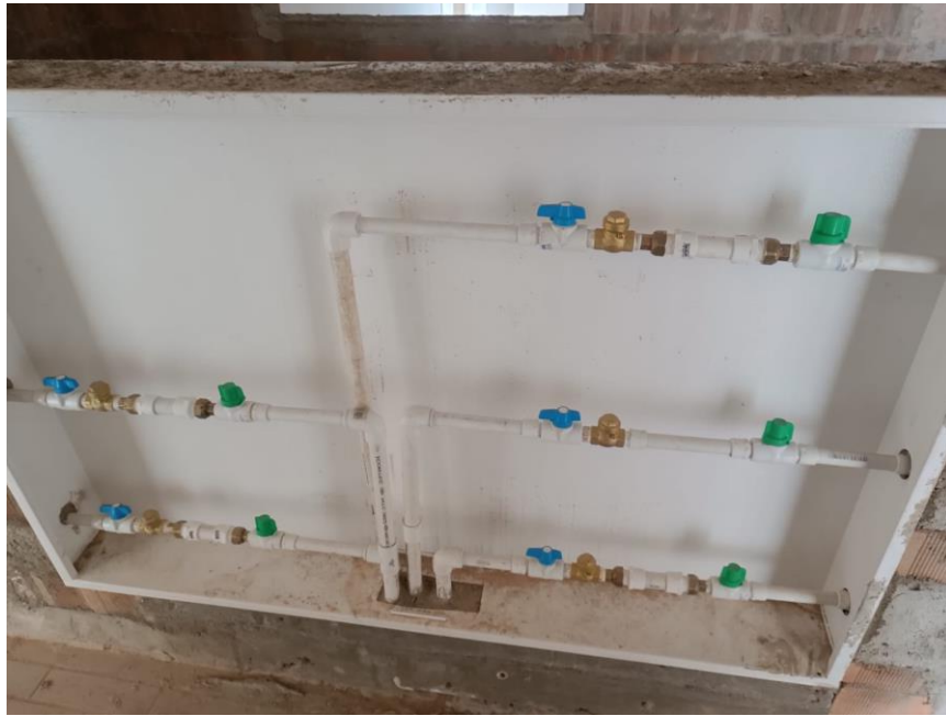
figura 20 Medidores de agua
