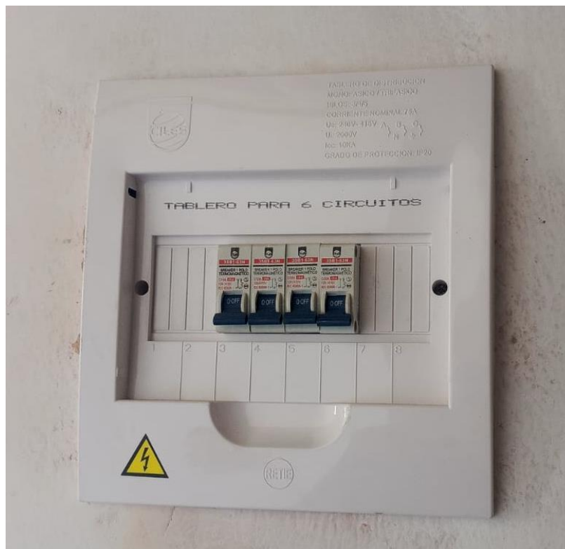
figura 25 Tablero de circuitos de cada apartamento
