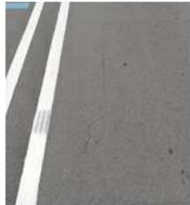
Fisura Longitudinal (FL)
