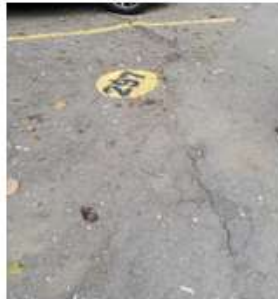
Fisuras Transversales (FT)
