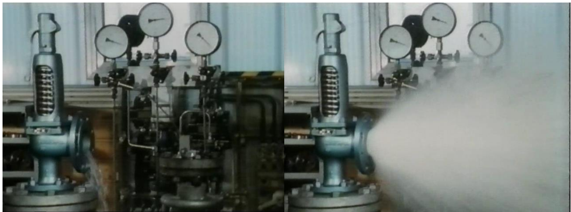
Figura 8. Válvula de alivio de seguridad en funcionamiento
