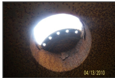
b) Manhole (A2) descascaramiento.
