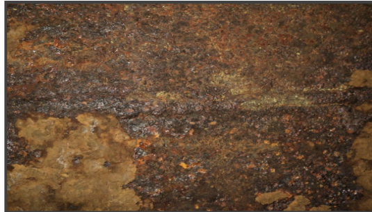
Figura. 25 Cordón de soldadura con presencia de corrosión por picadura.
