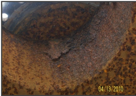
a) Manhole (A2) picado.
