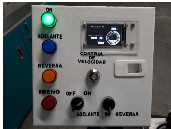
Fotografía 6. Tablero del sistema de control de giro
