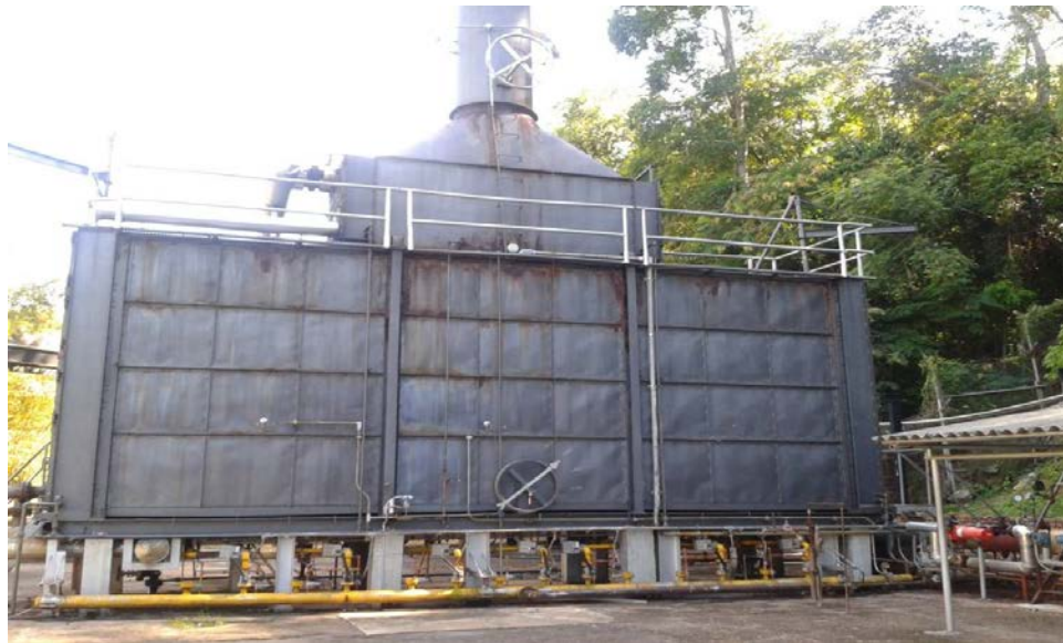
Figura 4. Registro fotográfico del horno de la Planta de procesos de gas El Centro.
