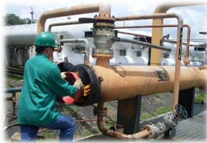
Figura 13. Operación de envío y recibo de raspador.
