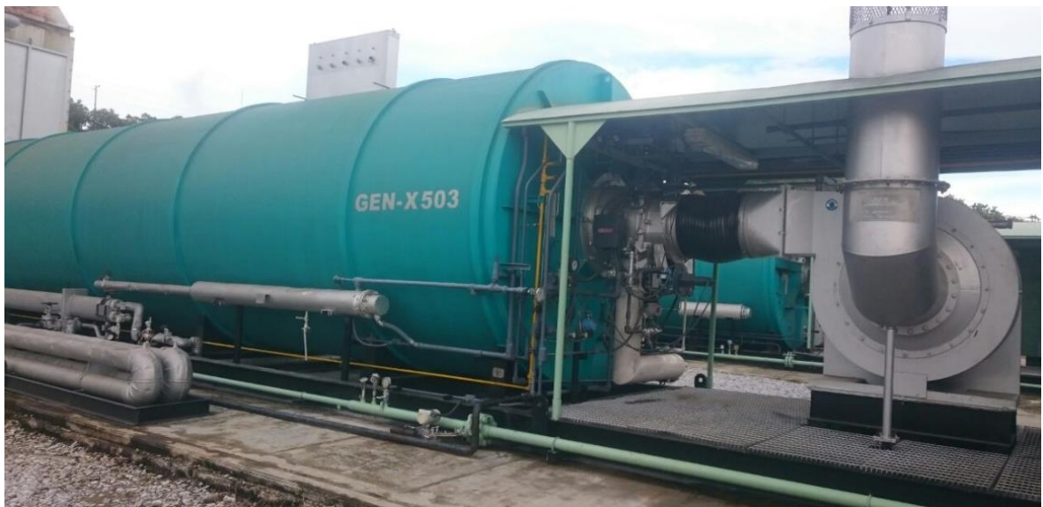
Figura 11 Generador de vapor
