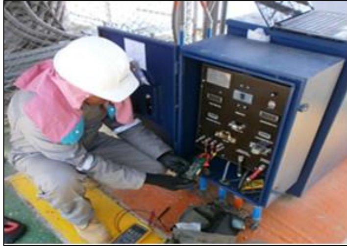
Figura 10. Inspección de parámetros operacionales de una URPC.
