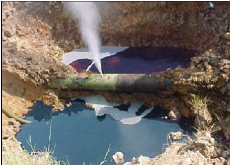
Figura 9. Daño por corrosión, de una tubería de transporte de combustible.
