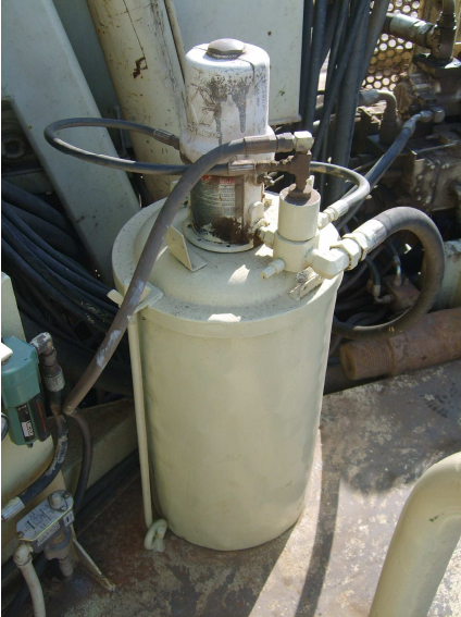
(a) BOMBA Y TANQUE GRASA
