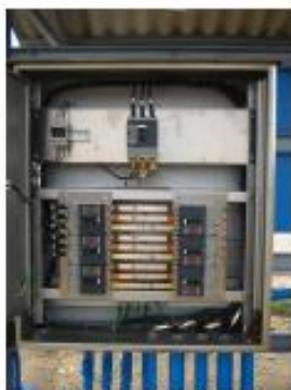
Foto IV. Cableado tablero de tablero
