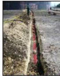
Fotografía 15. Saneada instalación circuito catódico
