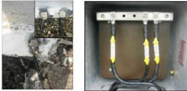
Fotografía 16. Soldadura exotérmica de 15 gr en pestaña de tanques y caja de conexión de negativos
