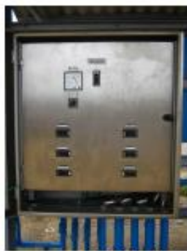
Foto V. Panel frontal de distribución.
