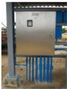
Foto VI. Caja tablero de Distribución
