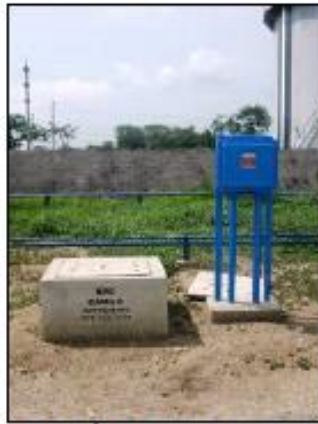
Fotografía 11. Registro en concreto
