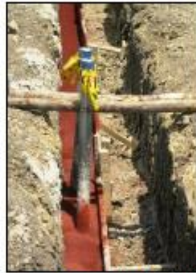
Foto 7. Acometida A.C de tablero De distribución a Rectificador No.1
