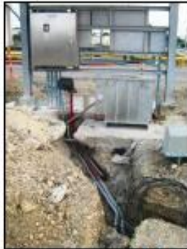
Foto 1. Acometida A.C a concreto de Tablero de distribución A.C
