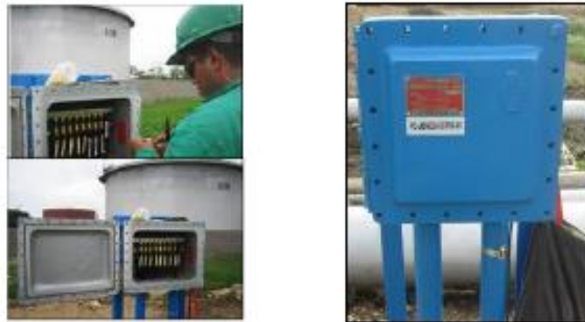
Fotografía 12. Conexión de anodos en caja de positivos
