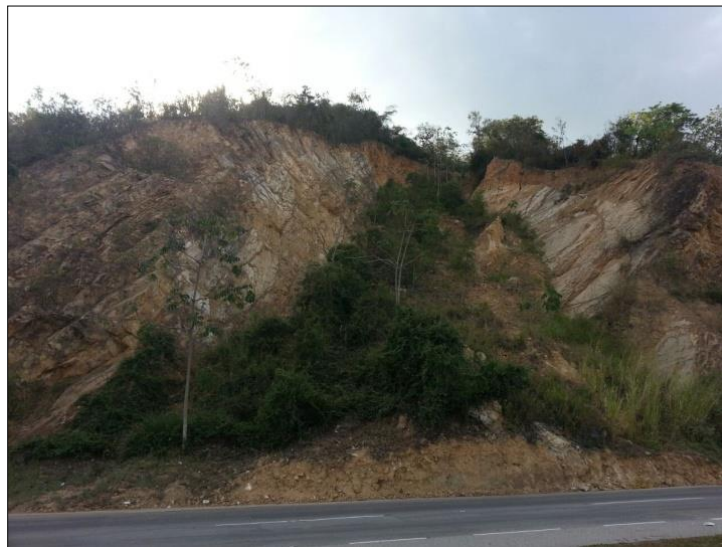
Figura 27. Deslizamiento en la vía Girón-Lebrija
