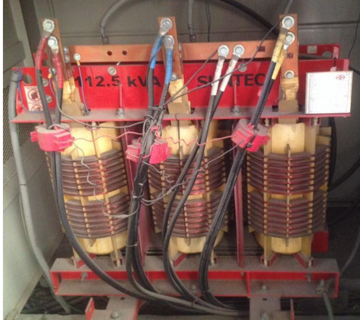
Figura 15. Transformador de la empresa de cárnicos.
