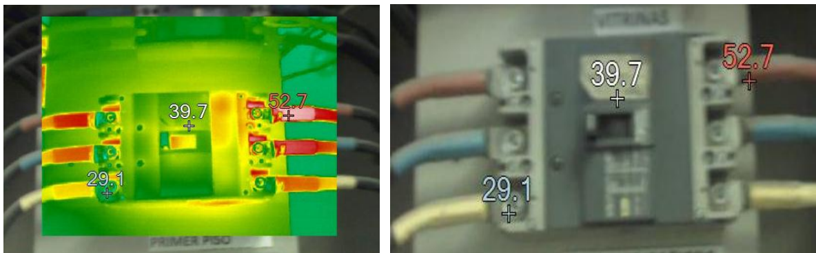
Figura 68. Totalizador principal del tablero de distribución de unidades refrigerantes y vitrinas.
