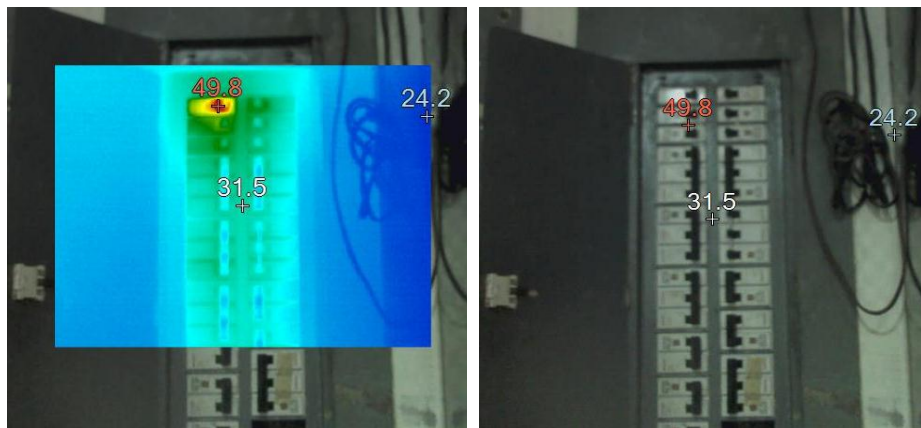
Figura 57. Tablero de distribución del sistema de iluminación y fuerza del primer y segundo piso.
