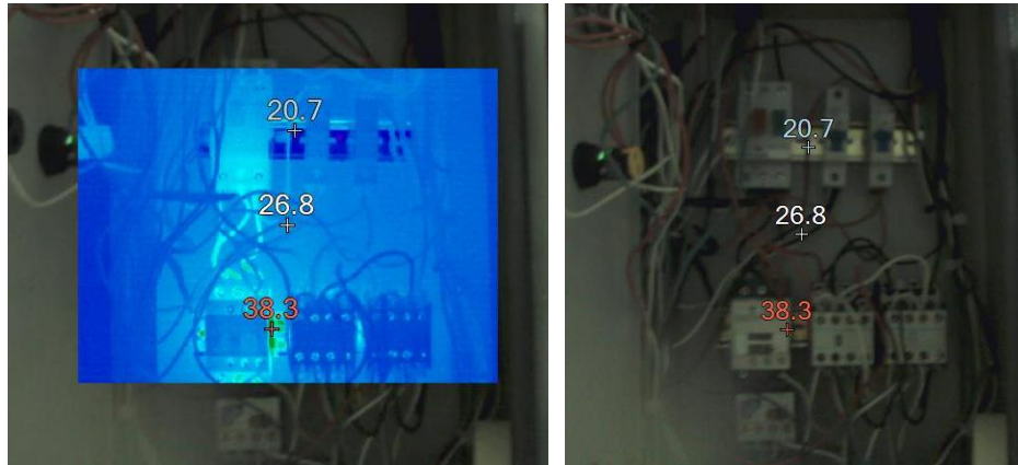
Figura 59. Caja de control de los elevadores:
