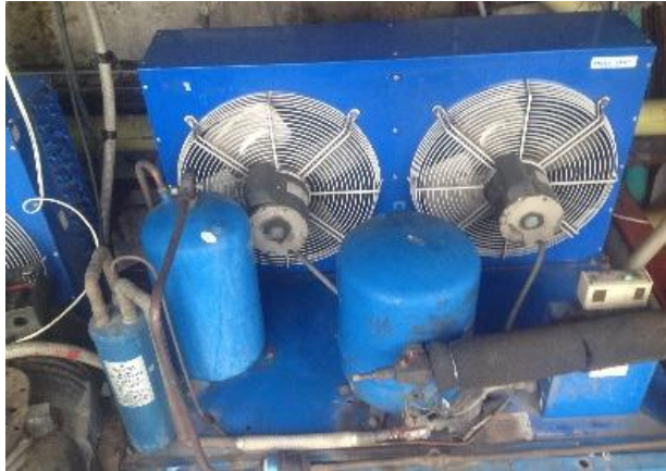
Figura 77. Compresor industrial para el sistema de refrigeración.
