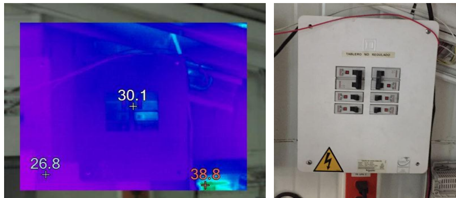
Figura 73. Tablero de distribución del sistema no regulado.
