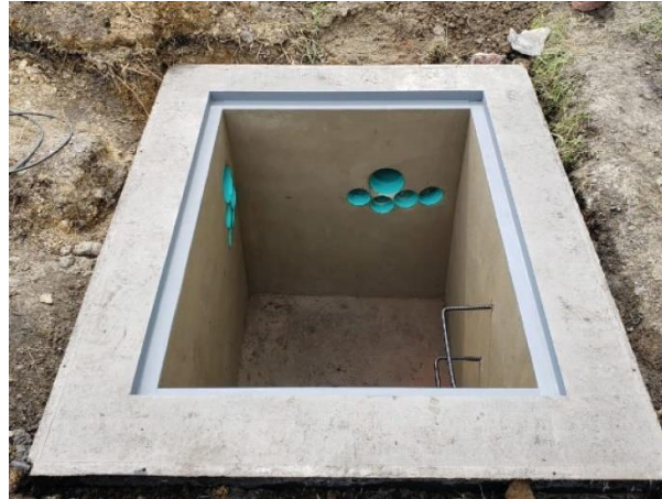
Ilustración 58. Caja de inspección eléctrica.
