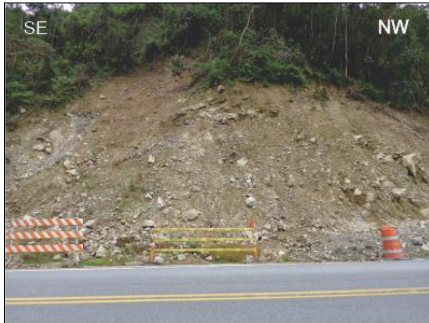
Figura 15. Ejemplo de Movimiento en Masa Tipo Deslizamiento y Caída Encontrada al Margen Izquierdo de la Carretera.
