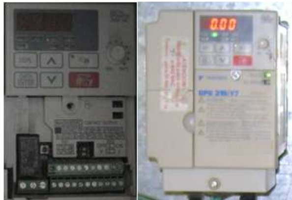
Figura 30. Variador de Velocidad Yaskawa V7 en funcionamiento
