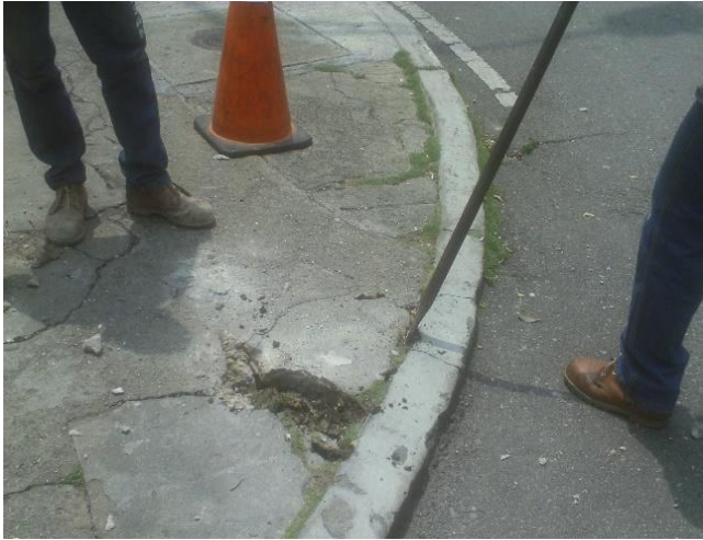
Fotografía 18. Rotura andén en concreto.
