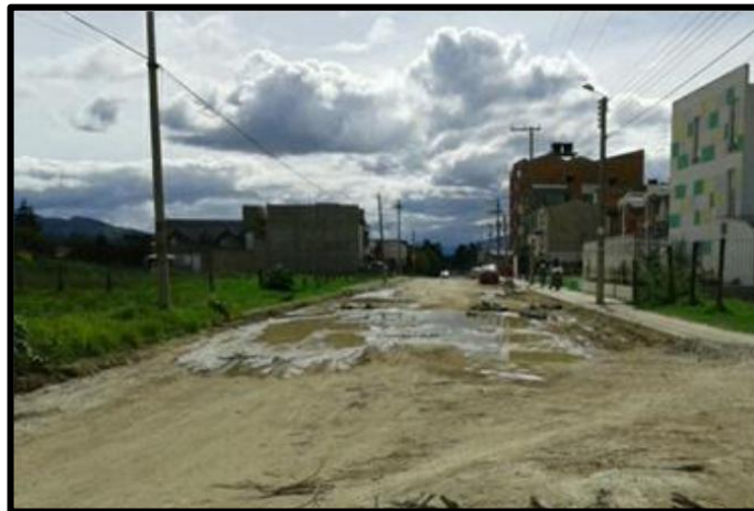
Figura: 8 Tramo sin intervenir, Cra 18 entre Calles 1 Y 3 Sur
