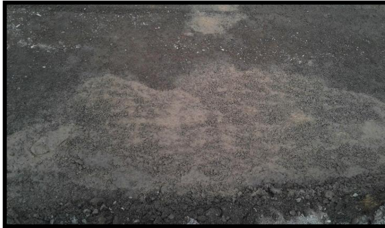
Figura: 30. Presencia de manchas por saturación en la vía.
