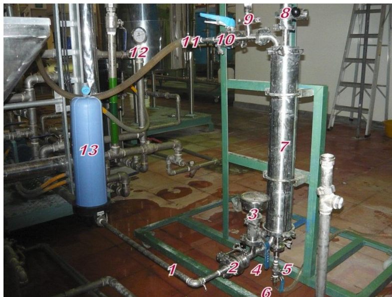
Figura 4. Vista frontal del montaje del sistema de ultrafiltración. Fuente: Autor.
