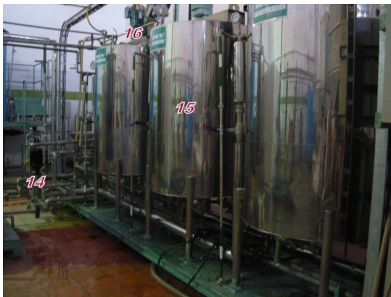
Figura 5. Vista posterior del montaje del sistema de ultrafiltración. Fuente: Autor.
