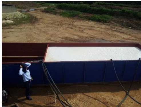
Figura 12. Tanque de Electrocoagulación
