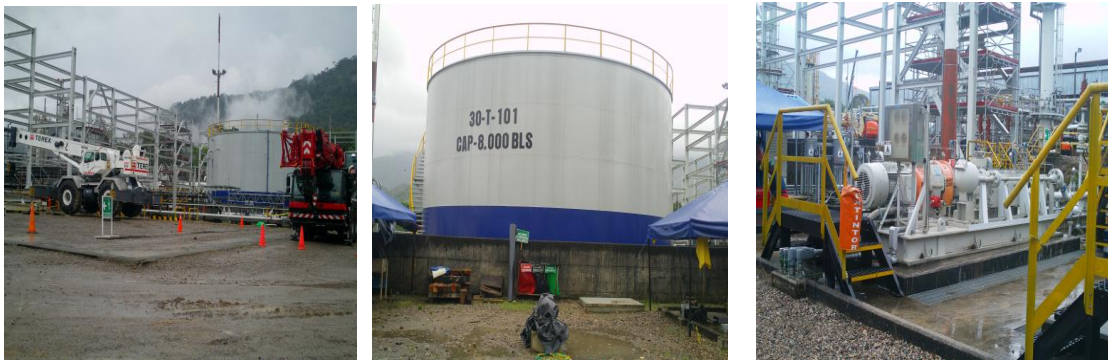
A. Área de carga por carro-tanques B. Tanque de almacenamiento. C. Bombas de transferencia a línea Multifásica
