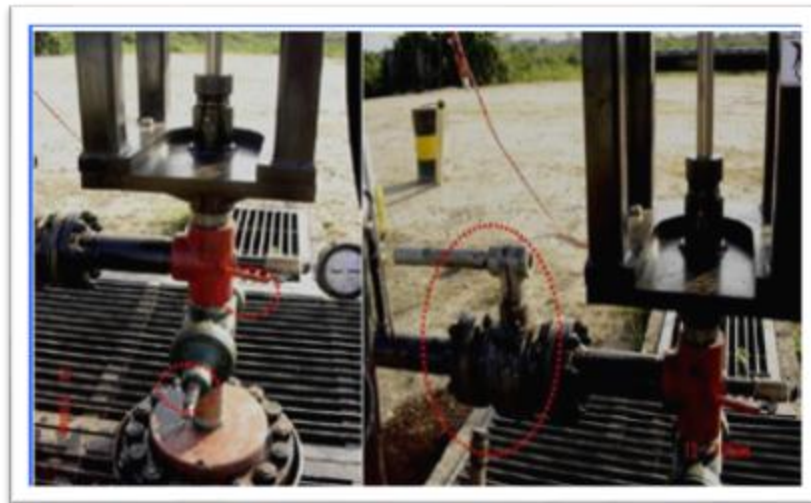
Figura 12. Cabezal de pozo
