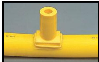
Falta de raspado
