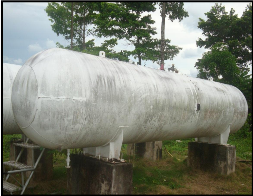
Figura 7: Tanques de almacenamiento GLP
