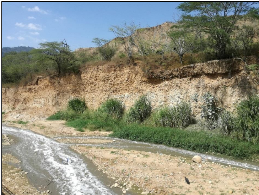
Figura 24. Quebrada Chimita, en la que se evidencian los procesos degradacionales que socavan el miembro órganos (Qbo) y la terraza media (Qal2), formando un valle de incisión a partir de los escarpes de terraza. Estación 9.
