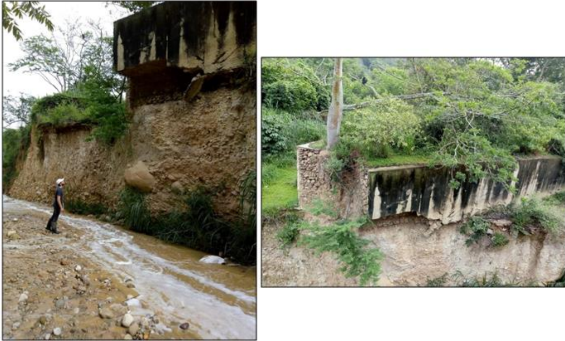
Figura 45. Foto 3 (izquierda) y foto 4 (derecha), en las que se observa el muro en gavión reforzado muy erosionado por el cauce de la quebrada.
