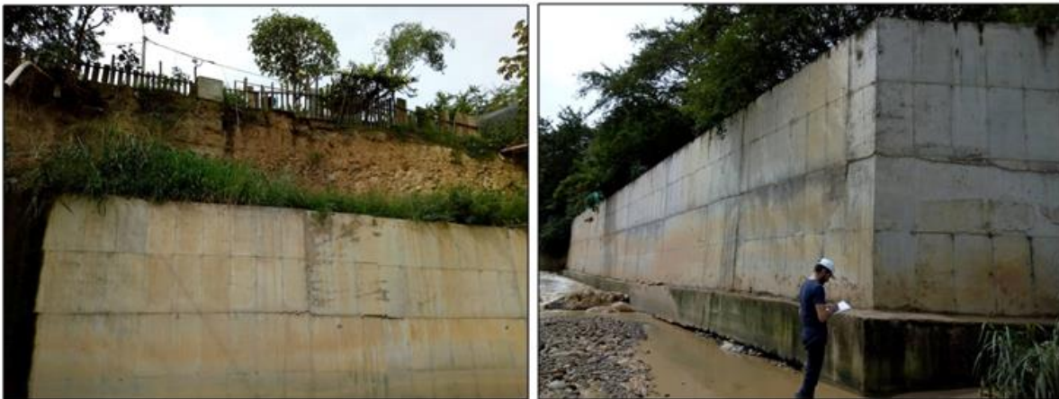
Figura 50. Foto 13 (izquierda) y foto 14 (derecha) en estas imágenes se observa el inicio y fin del muro en concreto con pilotes que canaliza la quebrada Chimita a medida que termina su paso frente al asentamiento.
