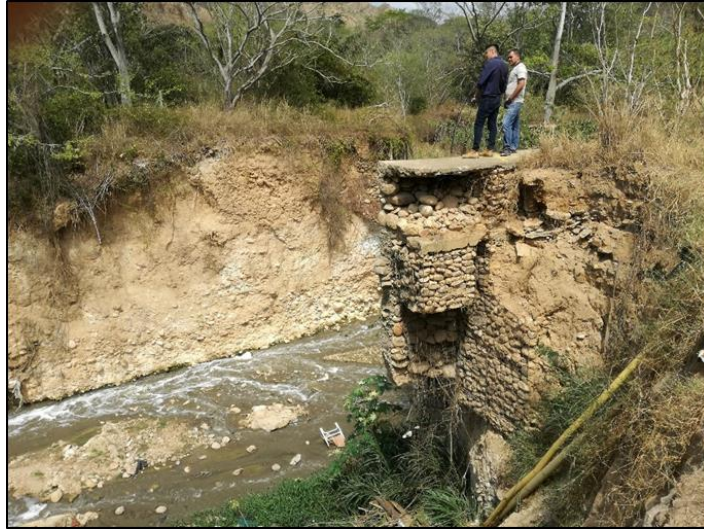
Figura 43. Obra de Canalización del sistema de drenaje que se encuentra erosionada por gravedad y flujo de la corriente de la quebrada Chimitá. Estación 9.
