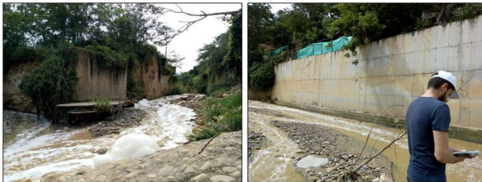
Figura 46. Foto 5 (izquierda) se evidencia la erosión del muro en gaviones reforzado en la unión de las quebradas La Joya y La Rosita que dan nacimiento a la quebrada Chimita. Foto 6 (derecha), en la que se observa el inicio del primer muro en concreto con pilotes al borde del asentamiento.
