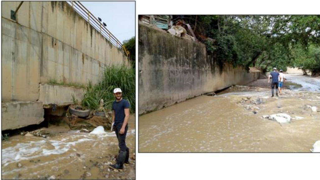
Figura 47. Foto 7 (izquierda) en la que se ve un desnivel en el muro de concreto con pilotes debido a que fue construido en épocas diferentes y no se logró un buen empalme, teniendo en cuenta el descenso de altura en la quebrada, ocasionando que la quebrada se filtre por debajo del muro socavando los cimientos. Foto 8 (derecha) se observa el nivel de descenso de la quebrada Chimita y la finalización del muro en concreto con pilotes para ser empalmado con un muro en gaviones con refuerzo.
