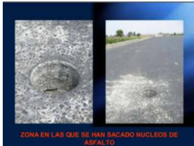
Figura 52 Huecos debido a la extracción de núcleo
