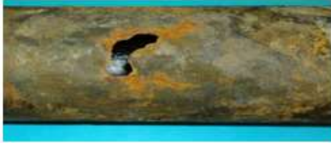
Figura 19: Tubería con evidencia de alta corrosión.
