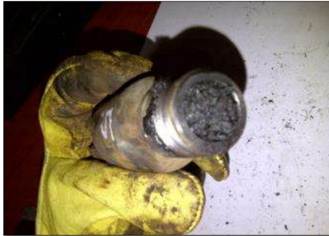
Figura 17: Válvulas cheques tapadas de Sedimento.
