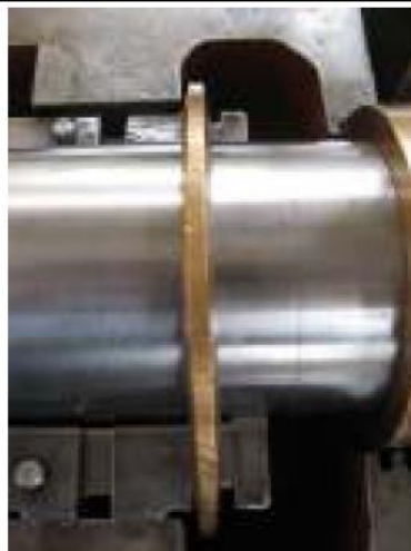
Figura 31. Desgaste y sobre-esfuerzo presentado en el anillo de Lubricación del Cojinete Radial lado acople
