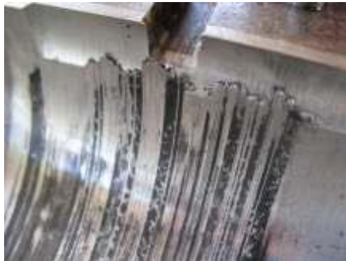
Figura 30. Desprendimiento del babbit en el Cojinete Radial del lado acople de la unidad
