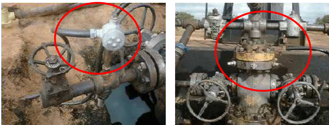
Figura 18. Conexiones de unidad de acondicionamiento de potencia al tubing
