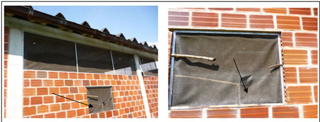
Figura 41 Malla en mal estado, cuarto de batido y moldeo
