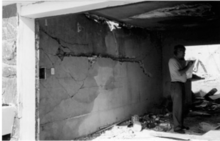
Figura. 1.5. Daños en una construcción por explosión de Gas natural. Foto tomada el 3 de Noviembre de 1995 en la ciudad de Río Tercero, Provincia de Córdoba Argentina 1
