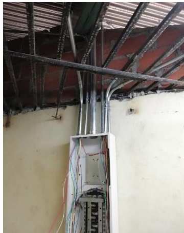
Figura 15. Tablero de distribución
