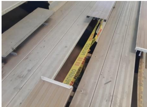
Figura 5. Estado de pasos de graderías en el coliseo antes de iniciar la obra.
