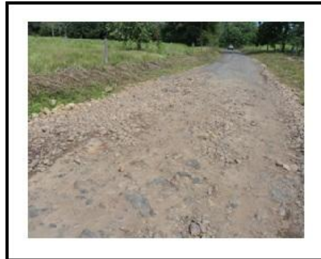
Figura 17. Punto Crítico por Paso de Agua
