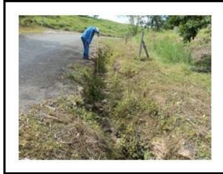
Figura 16. Erosión de Cunetas en el K1+512
