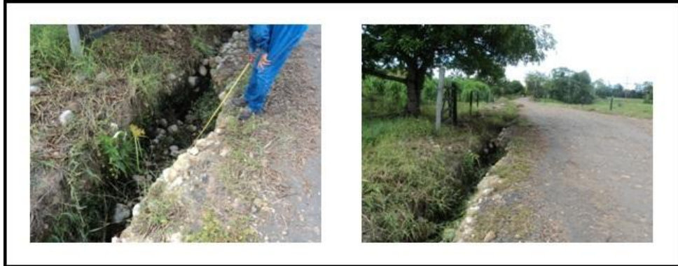
Figura 14. Erosión de Cunetas en el K1+262
