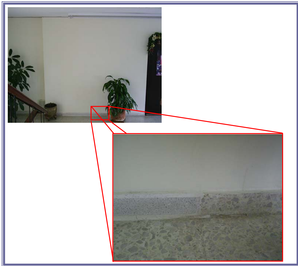
Figura 20. Detalles de remodelaciones no registradas en planos.
