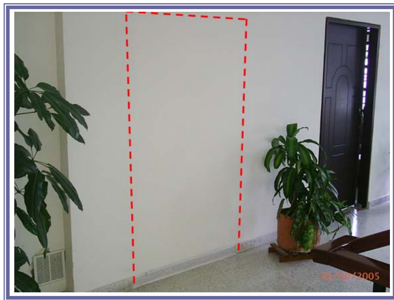
Figura 3. Detalles arquitectónicos no registrados en la información cartográfica de la Oficina de Planeación.
