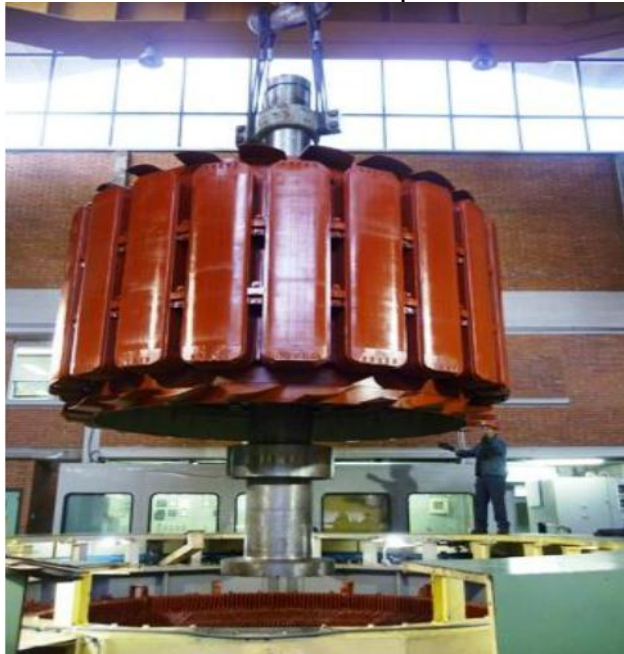
Ilustración 17. Rotor Generador Central Charquito.
