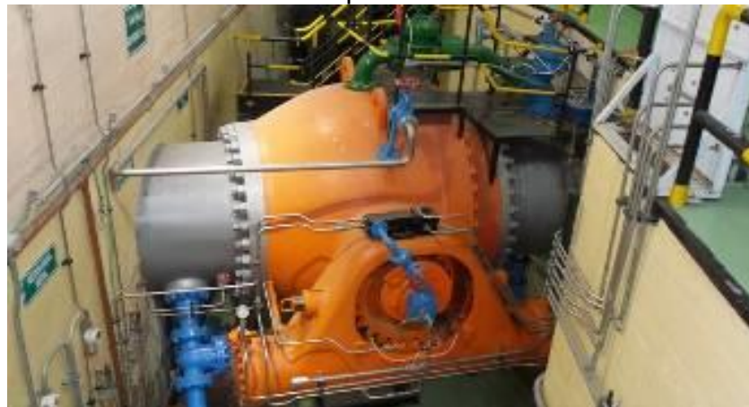
Ilustración 16. Válvula Esférica Principal Salto II.
