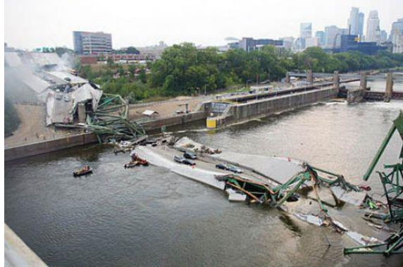
Figura 12. Puente I-35w Río Misisipi colapsado, Minnesota, Estados Unidos.
