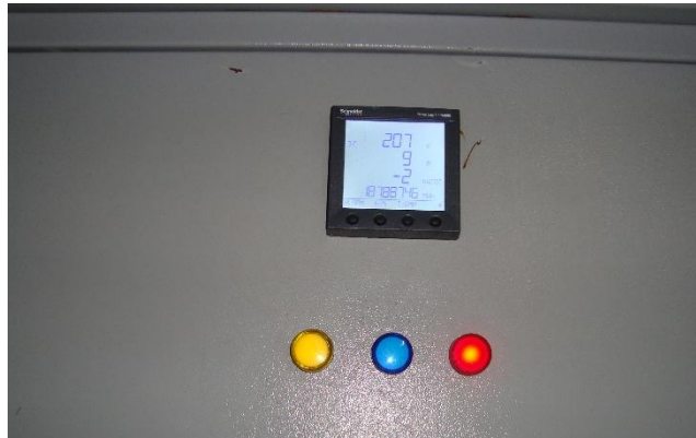
Figura 8. Medidor de Energía sobre Tablero General.
