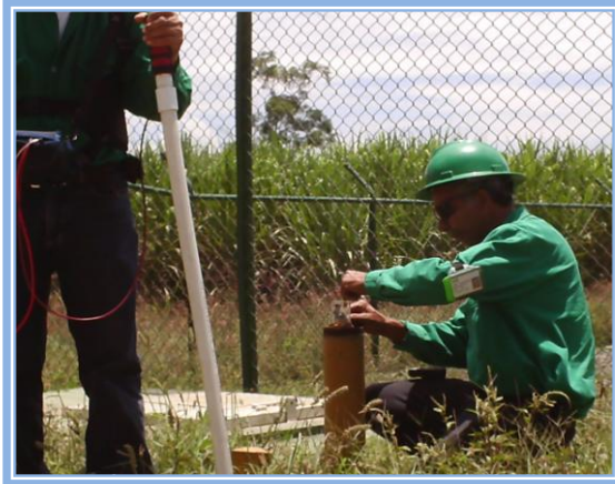
Figura 27. Conexión de cables
