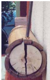
Foto 51 Falla taco de madera
