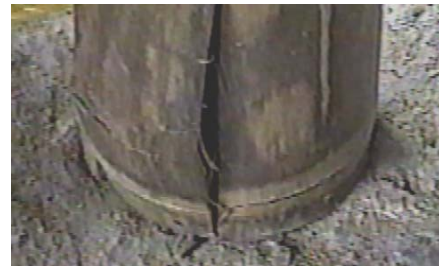
Foto 16 Falla por compresión paralela a las fibras
