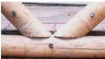
Foto 25 Falla por compresión paralela a las fibras
