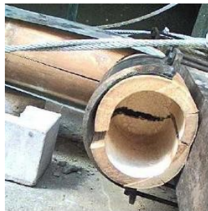
Foto 19 Falla por compresión a 90°
