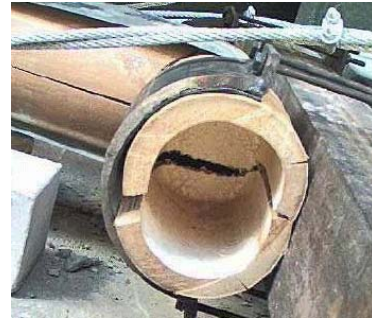
Foto 17 Falla por compresión perpendicular a las fibras
