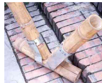
Foto 26 Falla por fluencia de la lámina
