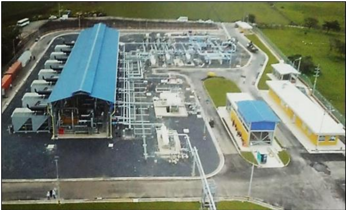
Ilustración 2. Estación de compresión típica (Puente Guillermo – Municipio de Puente Nacional - Santander)
