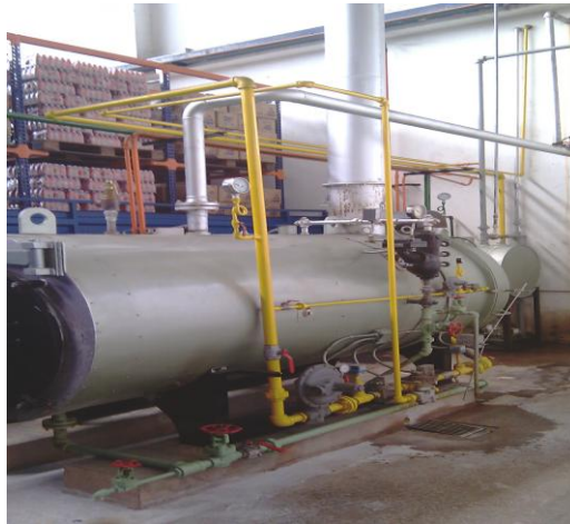
Foto 10. Suministro de Calor y Vapor de agua por caldera principal
