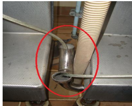
Mangueras de refrigeración
