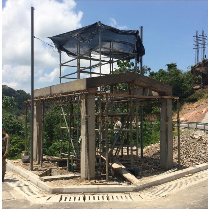
Figura 7. Estructura - Casetas de vigilancia.
