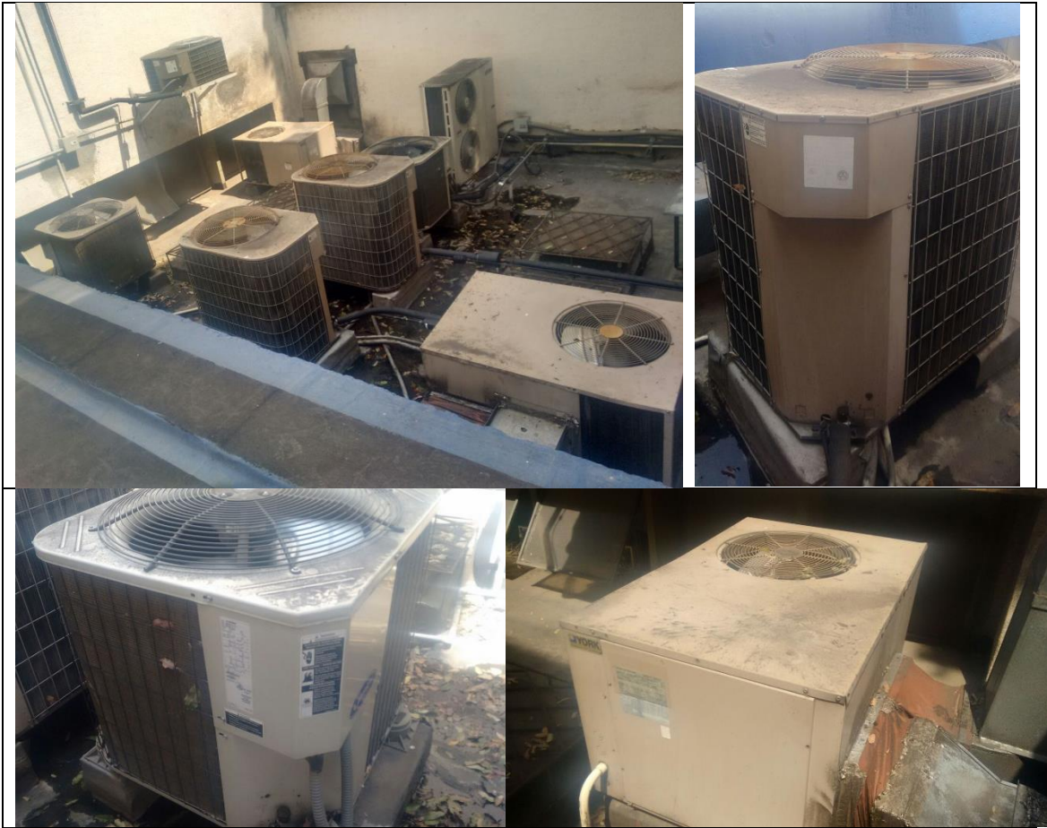
ANEXO O. Registro fotográfico aires acondicionados de Morfopatología.
