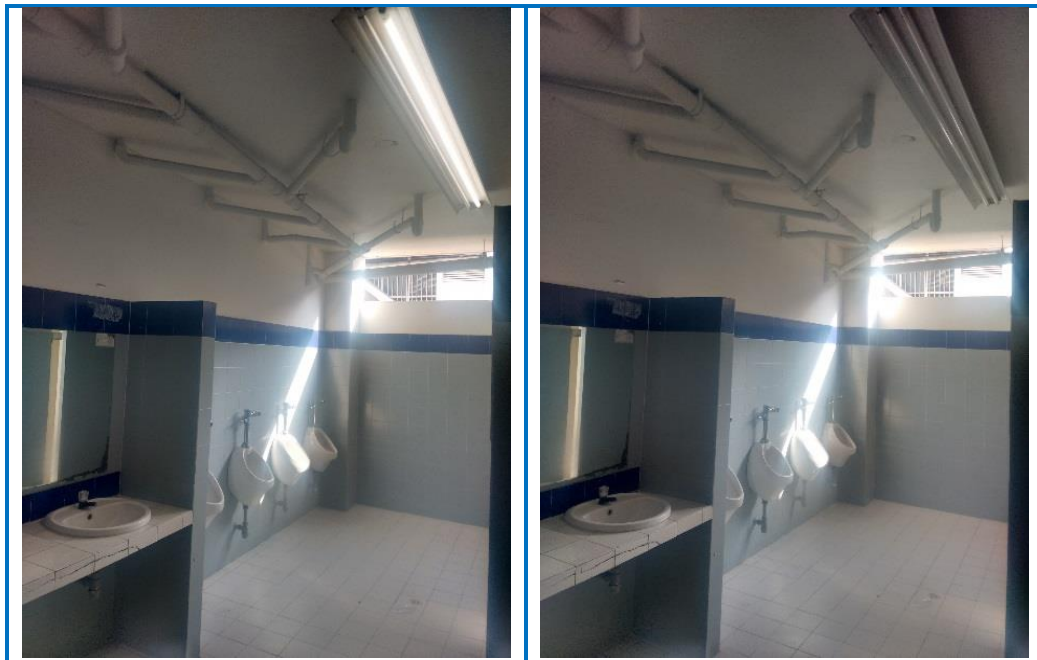
Figura 67. Baños edificio Roberto Serpa Flórez.
