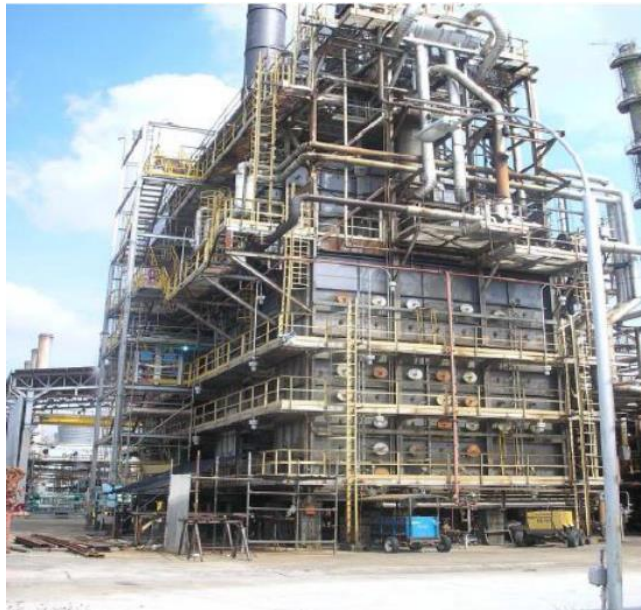
Figura 5 Horno de pirolisis Refinería Barrancabermeja.
